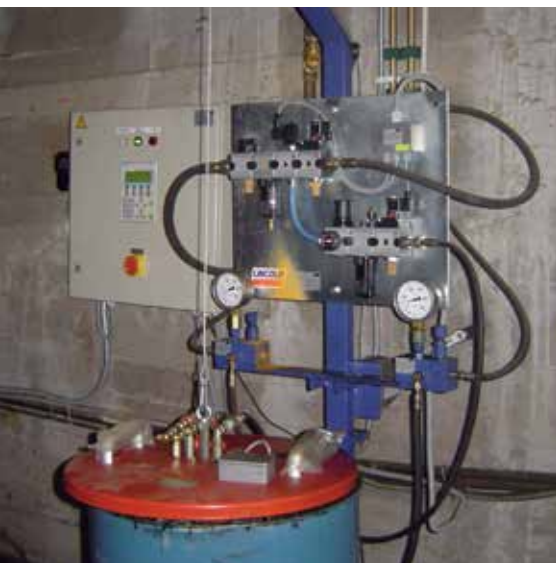
Завершена работа по монтажу автоматической централизованной системы смазки «Комплекс по обогащению апатит-штаффелитовых руд Ковдорского месторождения», АО «Ковдорский ГОК»
